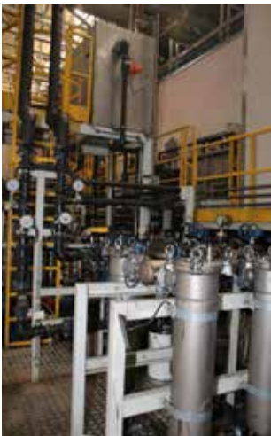
Благодаря трубопроводу на линии теперь нет проблем с деминерализованной водой
